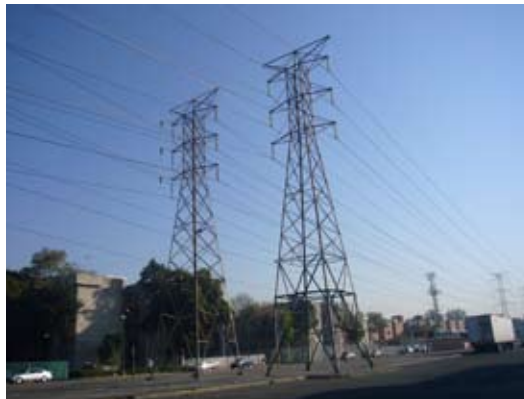
Torre de electricidad
